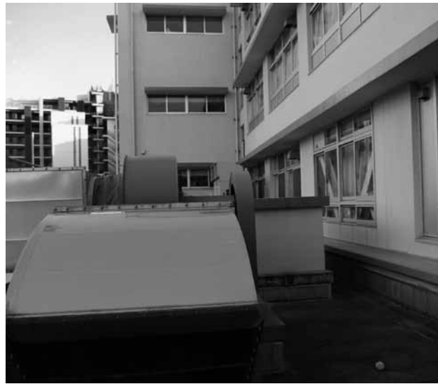
志村第2中学校の日本語学級教室の外に設置された室外機
